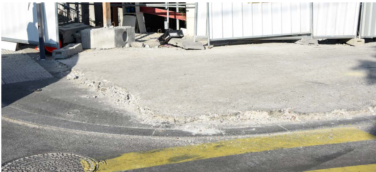
Le passage des camions et des engins de chantier particulièrement lourds abîment considérablement la voirie et les trottoirs. Les entreprises du BTP doivent impérativement rénover ces espaces pendant et après le chantier.
